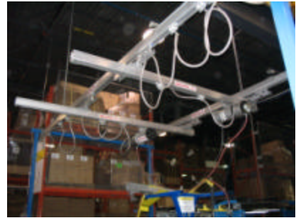
2 ponts roulants sur le même chemin de roulement Lumec
