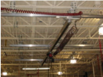
Pont roulant de 30' avec 3 chemins de roulement BRP (Valcourt)
